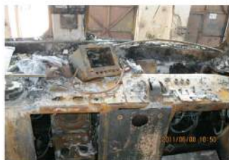
Efectele incendiului asupra echipamentului de comandă, indicare și protecție din postul de conducere nr. II
