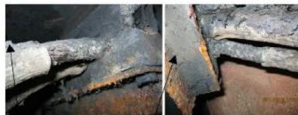
Conducătorul 778 de inseriere a motoarelor electrice de tracțiune nr. 2 și nr.5, cu porțiunea de 80 mm de izolație lipsă la intrarea în jugul canalului de cabluri
