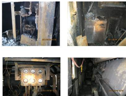
Efectele incendiului asupra echipamentelor din sala mașinilor.
